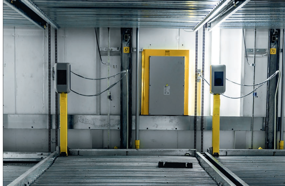
Der Schaltschrank wird platzsparend innerhalb der Anlage an der Rückwand montiert.
