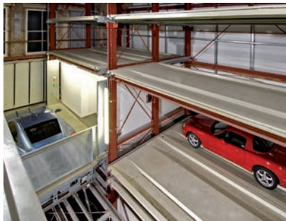
15 Mit gleichzeitigen X, Y Bewegungen (Vertikallift / Shuttle) erreicht die belegte Parkpalette die Übergabekabine Ausfahrt. Sehr gut zu sehen ist auch die rückwärtige Absicherung am Shuttle, um den Zugang zum Arbeitsbereich zu verhindern. With simultaneous X and Y movements (vertical lift / shuttle) the occupied parking pallet reaches the exiting area.
