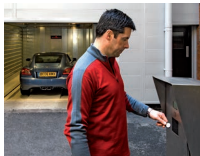
03 Der Fahrer bestätigt seinen Parkvorgang berührungslos mit seinem Transponder am Bedientableau. Laserscanner an der Decke prüfen die richtige Parkposition des Pkw, das Zufahrtstor wird geschlossen.
