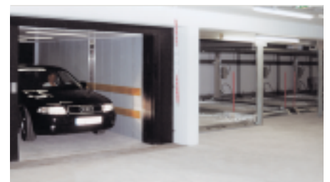
Im Parkhotel in Wiesbaden sind sowohl Autoaufzug als auch Combilift von Wöhr.
