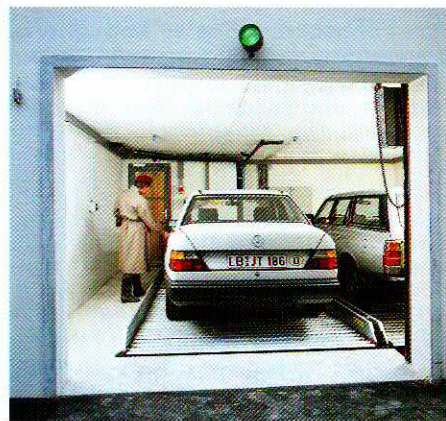
Die zum Parken im Einfahrtsbereich zur Verfügung stehende Fläche betrug lediglich 5,30 m x 5,30 m. Über Niveau waren normale Gebäudegeschoßhöhen zu beachten von ca. 2,10 m. Im Kellerbereich stand ausreichend Raum zur Verfügung.
