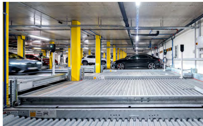
Mit dem unterirdischen Parksystem von WÖHR wurde oberirdisch Platz für autofreie Gassen und Aufenthalt geschaffen.
